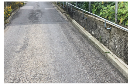
Abb. 28 – Haltestutz: Schneeräumung so, dass der Handlauf benützt werden kann.
